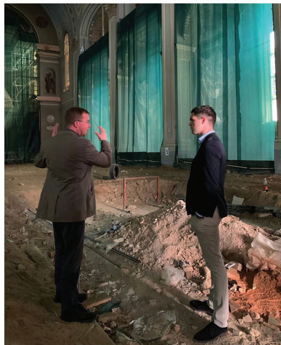
U obilasku zgrade Bazilike Srca Isusova u zagrebačkoj Palmotićevoj ulici nakon razornog potresa
